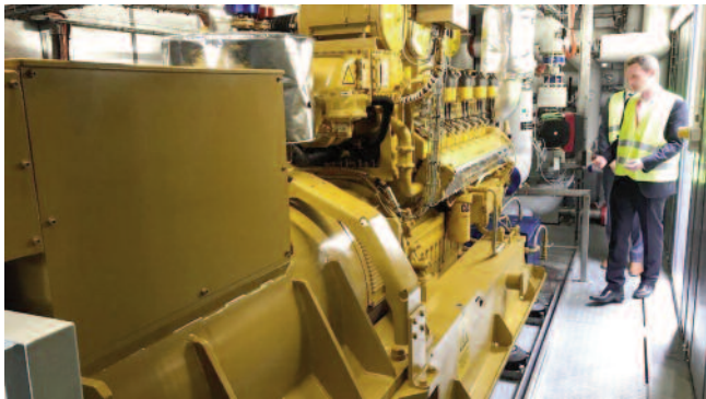
Unité de cogénération : de quoi produire en même temps de l'électricité et de la chaleur.
